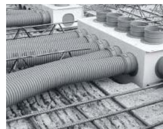
Strop w stanie surowym z przewodami powietrznymi
