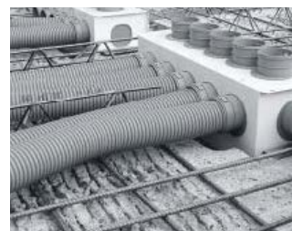
Strop w stanie surowym z przewodami powietrznymi
