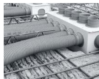
Strop w stanie surowym z przewodami powietrznymi
